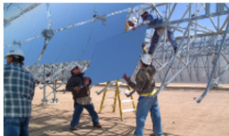
Figuur 8. Andasol is een elektriciteitscentrale op basis van zonne-energie van '100 MW' die momenteel in Spanje wordt gebouwd. De overtollige thermische energie die in de loop van de dag wordt opgebouwd, wordt maximaal zeven uur opgeslagen in tanks met vloeibaar zout, zodat een ononderbroken en gelijkmatige levering van elektriciteit aan het lichtnet mogelijk is. Het vermogen per oppervlakte-eenheid zal 10 W/m 2 bedragen. Foto: IEA SolarPACES.
